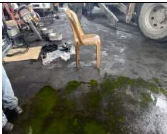
Apéndice 15 Pisos sin pintura impermeable.
